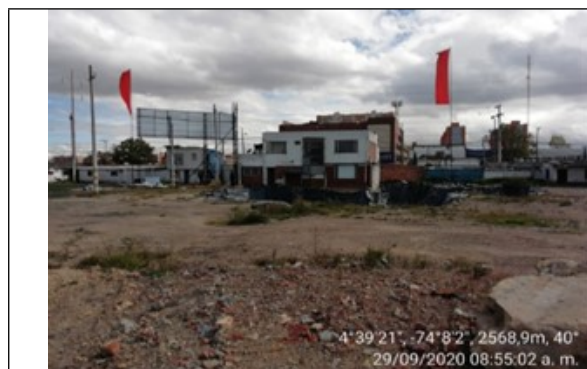
Fotografía 8. Estructura pendiente por demoler dentro del predio
